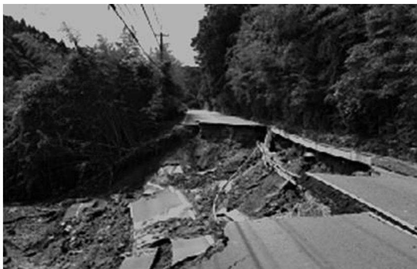
令和7年8月 大雨による道路崩落【石川県七尾市 国道249号】 出典：国土交通省
