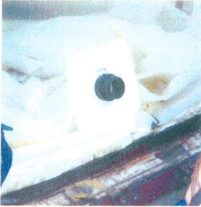
写真3 フレキシタンクの注入口
