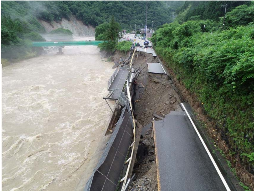
令和2年7月豪雨により国道41号が崩壊し、基幹道路が遮断された【岐阜県下呂市】 出典：国土交通省
